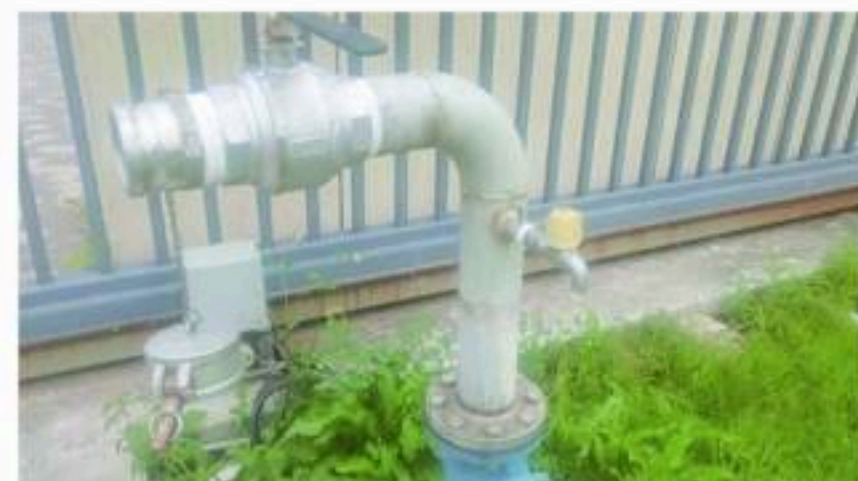
水資源回收中心備有快速接頭及水龍頭，桃園水資源回收中心放流水免費取用。
